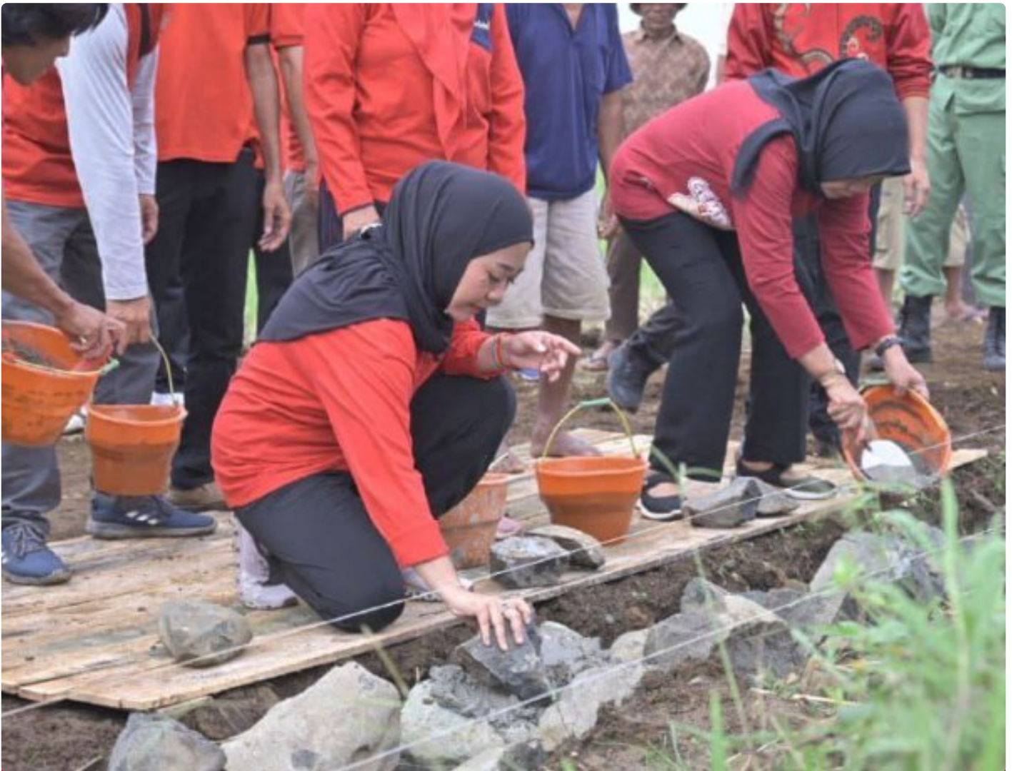
Bupati Purbalingga, Dyah Hayuning Pratiwi Letakan Batu Pertama Pembangunan Talud Irigasi di Desa Limbasari
